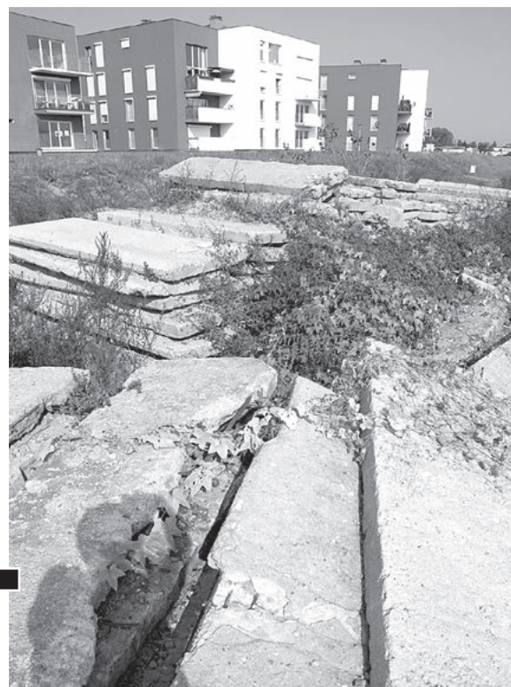
Betonowe płyty drogowe w pobliżu Warty – przy drodze rowerowej, naprzeciw bloków osiedla „Warta Park” fot. Piotr P. Ruskowski
