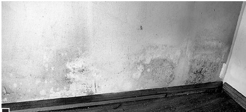
Zawilgocona ściana starej willi komunalnej przy ul. Armii Poznań 111 z widocznymi już śladami grzyba fot. Piotr P. Ruszkowski
