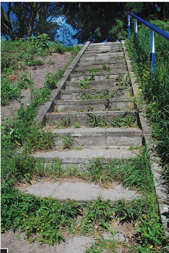
Zarośnięte niebezpiecznie schody przy ul. Spadzistej prowadzące nad Wartę, na plażę miejską fot. Piotr P. Ruskowski
