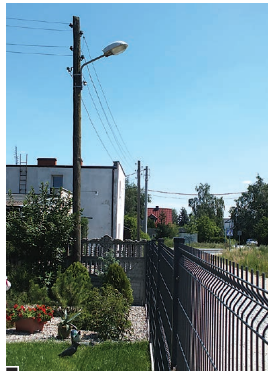
Stary, jeszcze drewniany, prywatny słup elektryczny na posesji przy Narcyzowej z jedną lampą na tej ulicy fot. Hanna Siatka
