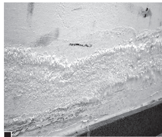
W innych miejscach od wilgoci luszczą się farba i tynk
