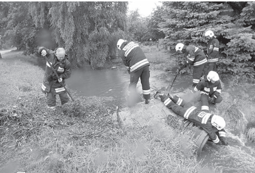
Strażacy odtykają zamknięty przepust w „dzikiej” zaporze, usuwając śmieci z kratownicy. Obok sterta wyciągniętych bosakami głównie gałązek i trawy, które zatkały kręgi fot. Hanna Siatka
