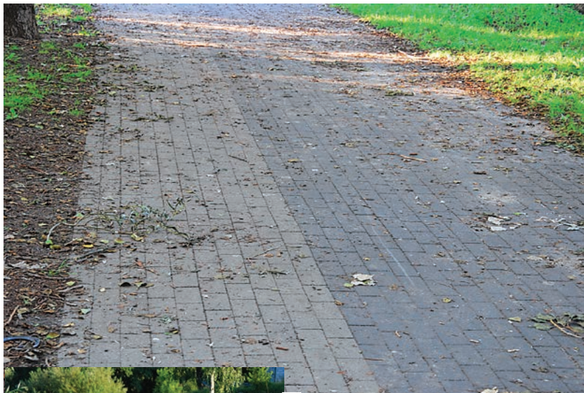
Nie sprzątany i nie konserwowany brukowy odcinek ścieżki rowerowej na Kocich Dołach fot. Piotr. P. Ruszkowski
