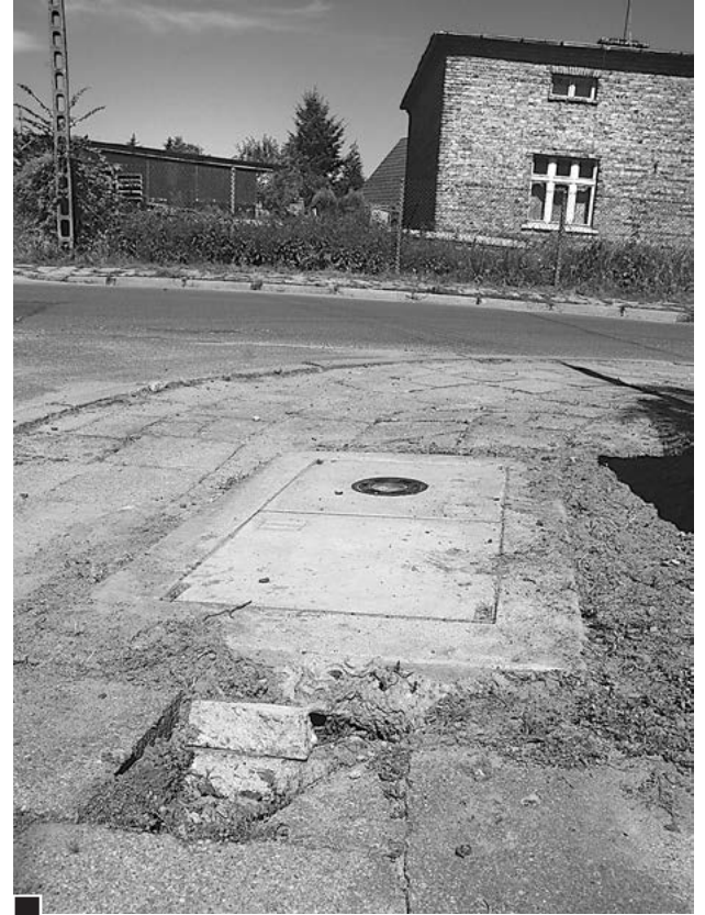
Niebezpiecznie zarwany chodnik przy studzience telekomunikacyjnej na skrzyżowaniu ul. 3 Maja i Spadzistej. Czy trzeba wybić zęby, żeby podjęto odpowiednie działania? fot. Piotr P. Ruszkowski
