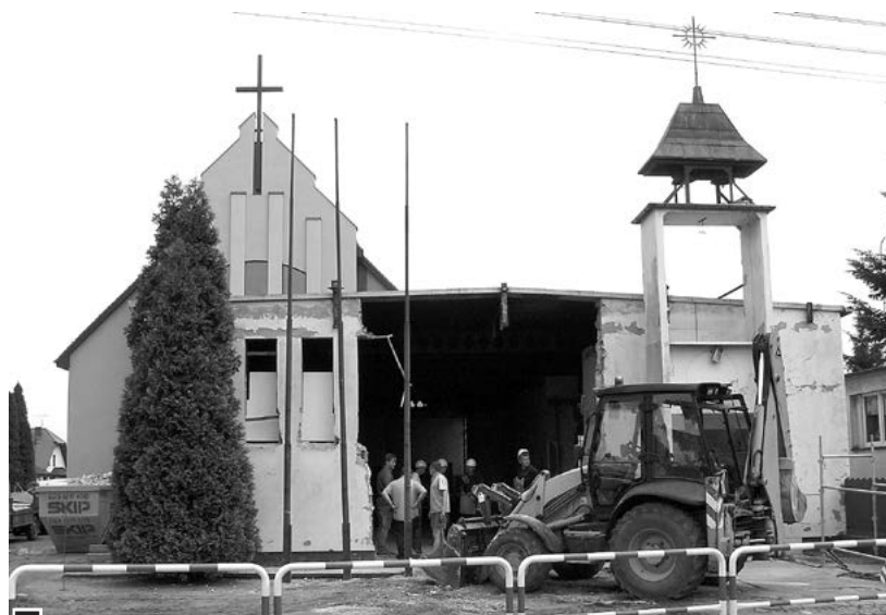
Ekipa remontowo-budowlana zaczęła przebudowę starego kościoła od rozbioru części ściany zachodniej fot. Paweł Wolniewicz
