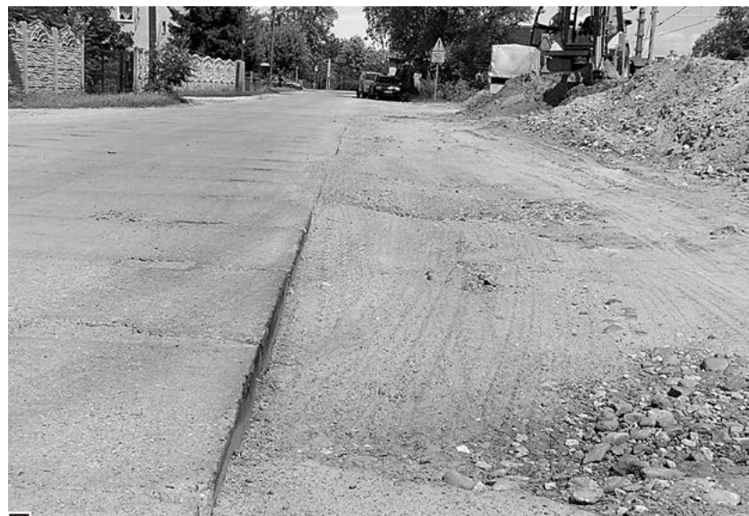
Niedostateczna szerokość odcinka ul. Dworcowej od Grzybowej do Walki Młodych z betonowych płyt i niebezpieczne zagłębienia w jezdni
