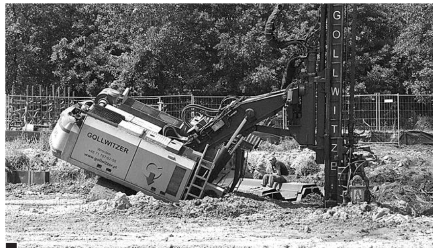
Urządzenie wykorzystywane do palowania obszaru budowy (kafar) pracujące na grząskim terenie przy ul. Wschodniej 19 niebezpiecznie przechyliło się fot. Piotr P. Ruszkowski
