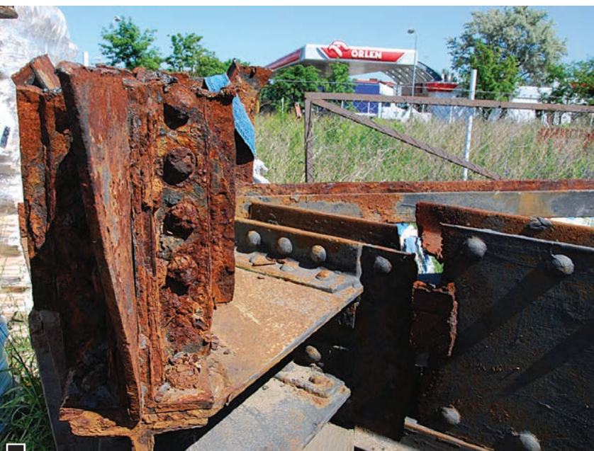
Postępująca korozja niezabezpieczonych fragmentów zabytkowego mostu. Z prawej strony widoczne niepotrzebne przecięcie konstrukcji nitowanej kratownicy, palnikiem podczas demontażu fot. Piotr P. Ruszkowski
