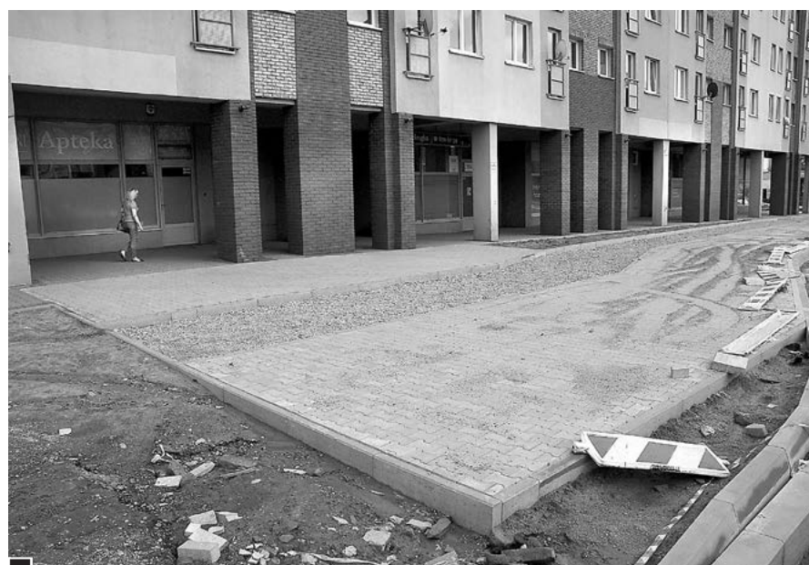
Jedna z granic trwającej inwestycji przy aptece na al. Jana Pawła II. W tym miejscu, tylko po wschodniej stronie, istniejący w podcieniach oraz nowy brukowy chodnik wraz z 2-metrową bitumiczną ścieżką rowerową będą miały szerokość ok. 15 metrów. Przypomnijmy też, że docelowo wszystkie jezdnie w NCL będą miały 8 m szerokości fot. Piotr P. Ruszkowski
