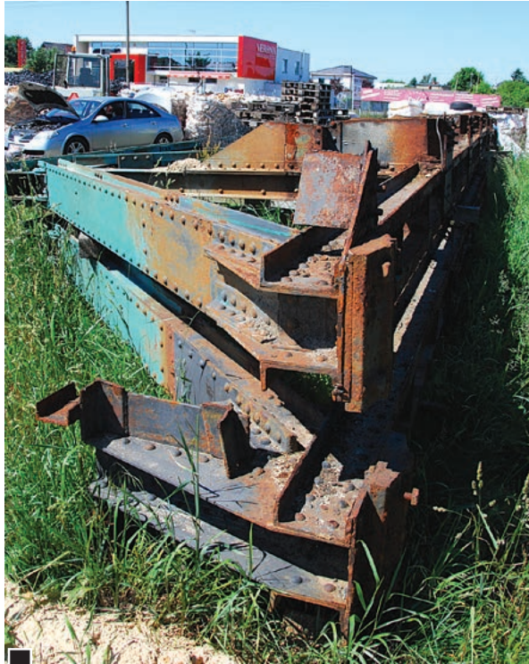
Przy ul. Sobieskiego naprzeciw restauracji „Verona”, w zielisku, czekają na swoje przeznaczenie przęsła zabytkowego mostu Zakładów Chemicznych. Czas leci, za chwilę półmetek 7. kadencji władz, korozja (zabezpieczonych jedynie przed kradzieżą) przęseł postępuje. Pomysłów ze strony władz, które przed dwoma laty wykazywały przedwyborczy entuzjazm, brak fot. Piotr P. Ruszkowski
