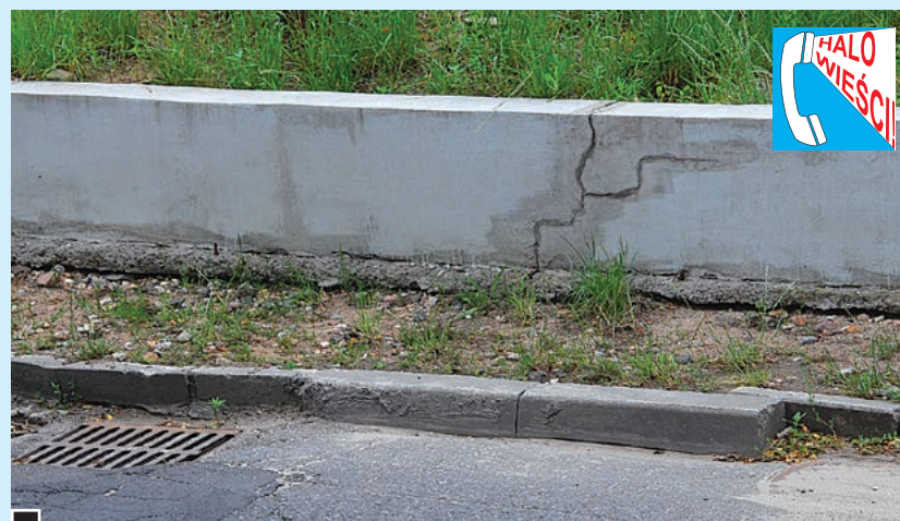
Wątpliwiej jakości ścianka oporowa przy wiadukcie na ul. Powstańców Wlkp. fot. Piotr P. Ruskowski
