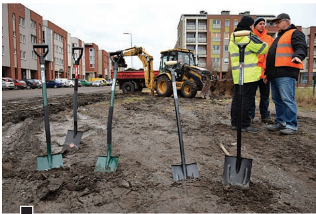
Ostatnie przygotowania do uroczystego rozpoczęcia prac budowlanych na ul. Wschodniej, na które Urząd Miasta zaprosił telewizję i lokalną prasę. W tle, specjalnie do zdjęć, sprowadzono czerwoną wywrotkę i żółtą koparkę, które symulowały roboty w błocie fot. Piotr P. Ruszkowski
