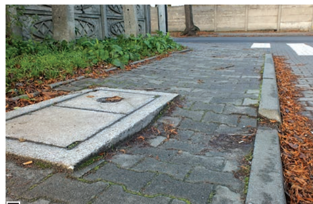
Niebezpieczny, zniszczony fragment chodnika na ul. Leśmiana z wystającą, betonową studzienką i wyboistym chodnikiem (w głębi ul. Poniatowskiego) fot. Hanna Siatka
