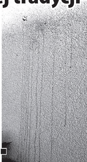
Zniszczona elewacja budynku mieszkalnego przy ul. Akacyjnej
