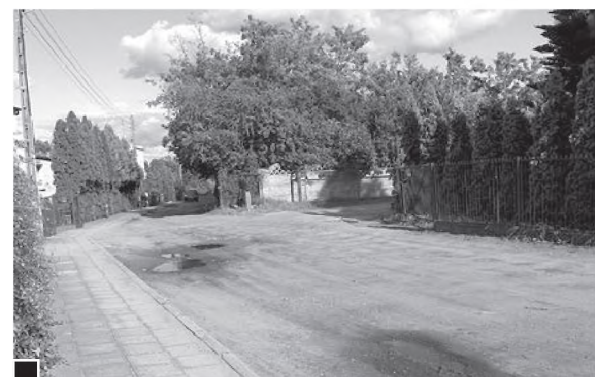
Zwężenie 60-metrowego odcinka ul. Juranda. Na zdjęciu widać różnicę w szerokości drogi fot. Agata Samol
