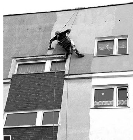
Północna elewacja bloku mieszkalnego w Luboniance przy ul. Sikorskiego 3 odnawiana przez alpinistów 2 listopada fot. Piotr P. Ruszkowski
