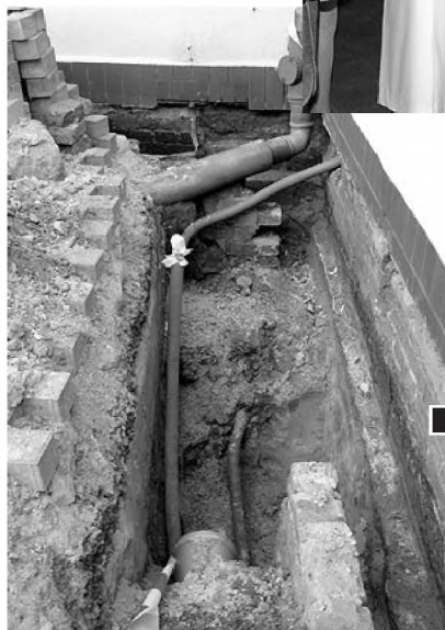
Naprawiając system odwodnienia, położono nowe rury o większym przekroju fot. Paweł Wolniewicz
