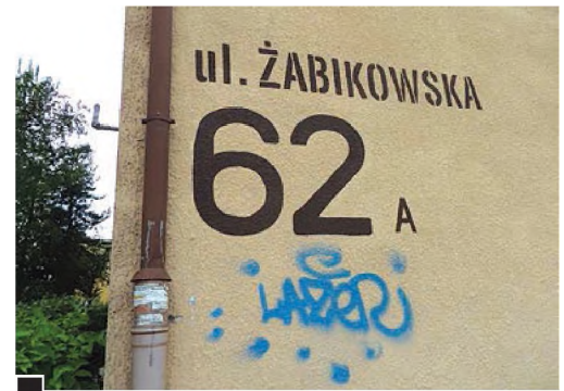
Bazgroły na ścianie pierwszego od głównej ulicy budynku przy Żabikowskiej 62A i resztki ogłoszeń na rynnie
