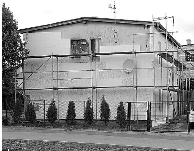
Ocieplanie styropianem domu komunalnego przy ul. 3 Maja 29. Tego zadania nie ma w oficjalnym wykazie inwestycji, przesłanym bezpośrednio z Urzędu Miasta fot. Piotr P. Ruszkowski
