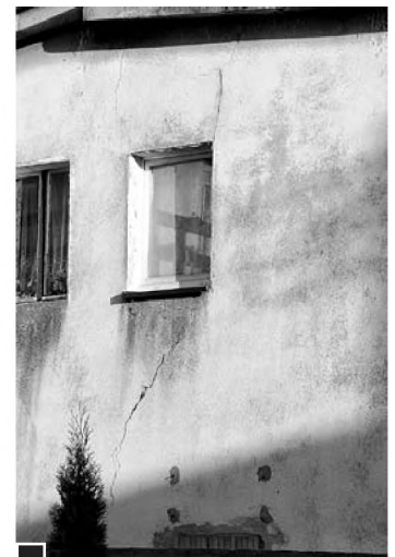
Za chwilę północna ściana nośna budynku komunalnego przy ul. 3 Maja 29, na której widać pionowe spękania, zostanie przykryta styropianem fot. Piotr P. Ruszkowski
