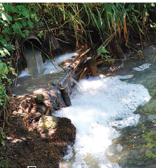
Ukryta w zaroślach niepozorna szara rura PCV, prawdopodobnie sporadycznie wykorzystywana do zrzutu nieczystości z nieznanego źródła. Wyraźnie widać, jak szara substancja przy ujściu pieni się fot. Piotr P. Ruskowski
