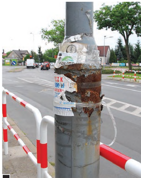
Dzisiejszy stan – słup latarni miejskiej na ul. 11 Listopada (okolice skrzyżowania z Kościuszki) z wyraźną korozją stali wywołaną klejami plakatów, ogłoszeń itp. fot. Piotr P. Ruskowski
