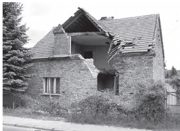
W środku nocy, przez zapadnięcie się nadproża okiennego, które pociągnęło za sobą część konstrukcji, zawalił się fragment domu przy ul. 3 Maja 14 fot. Piotr P. Ruszkowski
