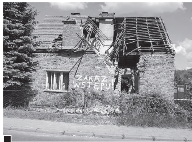
Dom nadal stoi. Pat prawny nie pozwala rodzinie na rozebranie niebezpiecznej części, pozostawia na nich jednak odpowiedzialność za ewentualne skutki. Zabezpieczeniem dla poszukiwaczy metalu – tragarzy stropowych ma być napis „ZAKAZ WSTĘPU!” fot. Piotr P. Ruszkowski
