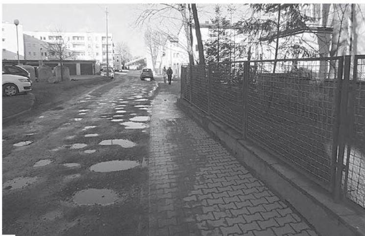
Z dziurawej jezdni ul. Źródlanej na chodnik dostaje się woda z kałuż i błoto fot. Hanna Siatka
