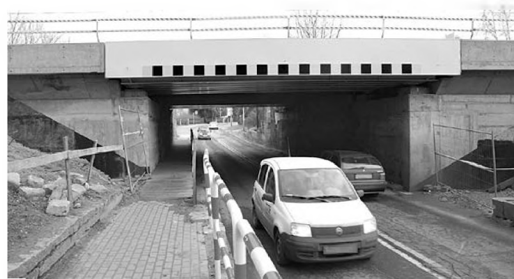
Nowy, budowany w połowie drugiej dekady XXI wieku prawie od zera wiadukt kolejowy w ul. Powstańców Wlkp. na jednej z główniejszych ulic Lubonia zachował parametry z przełomu XIX i XX wieku fot. Piotr P. Ruszkowski
