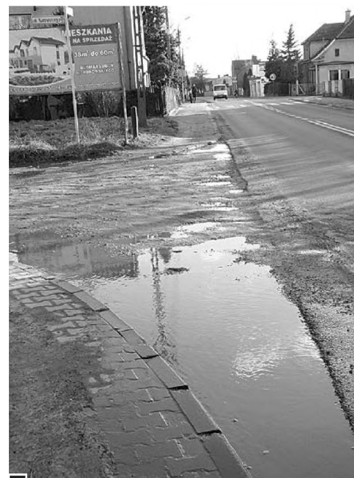
Stan chodników na ul. Sobieskiego – niepełnosprawny na wózku, nawet gdyby bardzo chciał, nie podjedzie pod taki krawężnik, ani w żadnym miejscu go nie omiśnie. Koła grzęzną w błocie. Takich przeszkód na ul. Sobieskiego ma do pokonania dziesiątki, nic dziwnego, że wybiera ruchliwą jezdnię fot. Hanna Siatka
