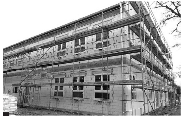
Nowy segment SP 1 – stan na 29 stycznia – rozpoczęto przyklejanie styropianu ocieplającego od strony ul. Szkolnej
