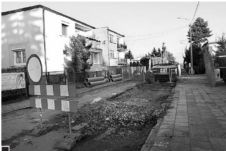
Budowy kanalizacji sanitarnej, deszczowej i nawierzchni na ul. 1 Maja fot. Hanna Siatka
