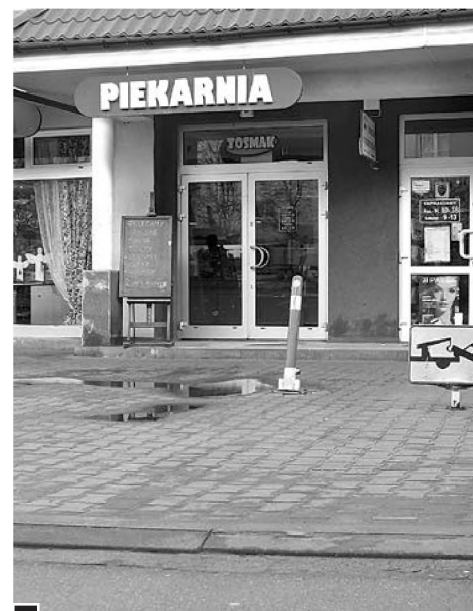
Krawężnik dla samochodów dostawczych „złagodzony”, stopnia przed piekarnią nie. To przykład z ul. Osiedlowej w Spółdzielni „Lubonianka”, gdzie podobne ułatwienia przewidziano np. dla śmieciarek, a krawężniki dla korzystających z chodników pozostawiają wysokie (m.in. również droga do osiedla z ul. Kościuszki na tyłach boiska SP 2) fot. Hanna Siatka
