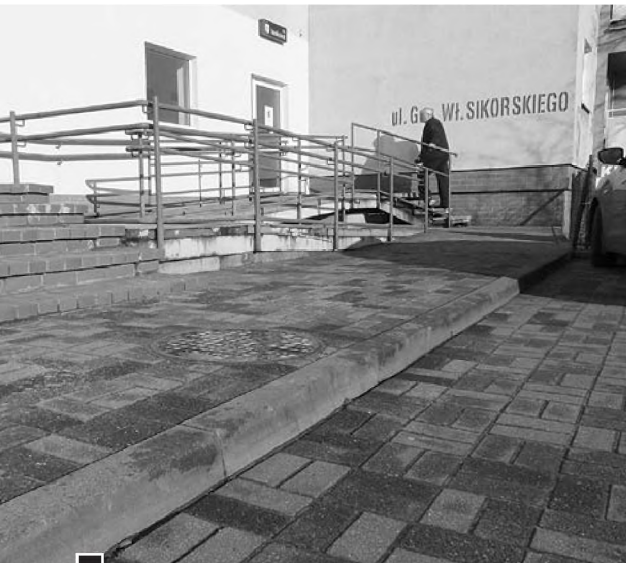
Cóż z tego, że poprawny, skoro trudno dostępny? – dwupoziomowy, niwelujący dużą różnicę wysokości podjazd z poręczami prowadzący do pomieszczenia z bankomatami przy PKO BP na ul. Sikorskiego, od strony parkingu niedostępny z powodu wysokiego krawężnika fot. Hanna Siatka
