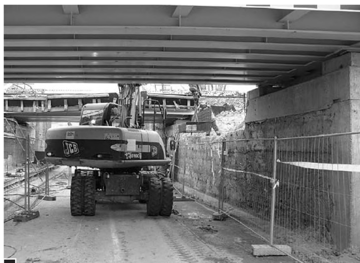
Modernizacja przyczółków wiaduktu polega na wzmacnianiu starych, kruszących się betonowych podpór około metrowej grubości warstwą nowego żelbetonu. Tak niewiele brakowało do budowy nowego, szerokiego wiaduktu na miarę XXI wieku – wystarczyło wątpliwej jakości resztki betonu pochodzącego z kilku okresów (przełomu wieków XIX/XX i z czasów II wojny) zastąpić przyczółkami z nowego żelbetu o jednolitej, zwartej konstrukcji, posadowionymi kilka metrów dalej, poszerzając w ten sposób pas ruchu i wygospodarowując miejsce na wygodne przejście oraz trasę rowerową fot. Paweł Wolniewicz
