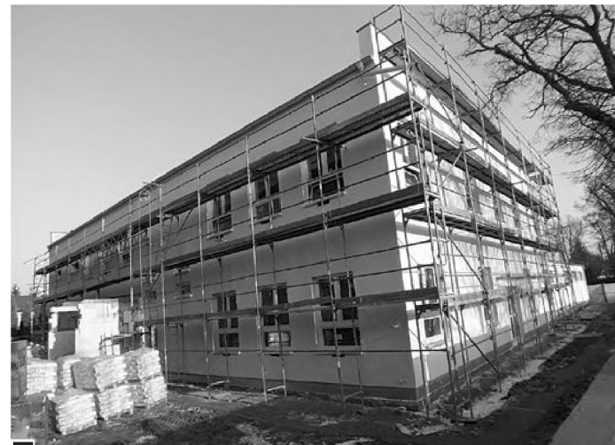
Podobne ujęcie dwa tygodnie później – 13 lutego – ściany już ocieplone, zaciągnięte siatką i otynkowane. Okna uzbrojono w parapety, wykonano opierzenie dachu. Na koniec stycznia trwały prace tynkarskie wewnątrz budynku fot. Hanna Siatka
