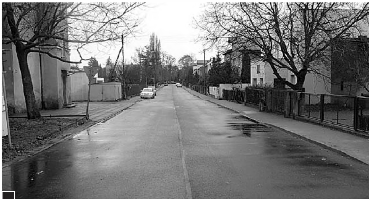
Po zakończeniu robót ziemnych w ul. Cieszkowskiego odtworzono nawierzchnię jezdni w linii wykonywanego kanału oraz warstwę ścieralną na całej szerokości drogi fot. Paweł Wolniewicz
