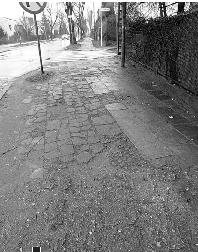
Chodnik w dalszym przebiegu ul. Kościuszki – przed ul. Kilińskiego – wygląda jak po ostrzale: popękane i wykruszone płyty (uszkodzonych jest więcej niż tych w dobrym stanie) fot. Hanna Siatka
