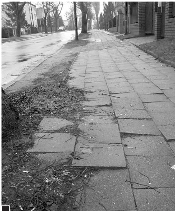
Przykład niebezpiecznych nierówności na odcinku pomiędzy ul. Kilińskiego i Skóry. Wieczorem, przy niedostatecznym na tej ulicy oświetleniu, trudno tu utrzymać równowagę fot. Hanna Siatka
