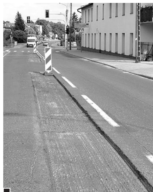
Kończy się tegoroczny remont cząstkowy nawierzchni lubońskich ulic. Na zdjęciu łatanie ul. Powstańców Wlkp. w okolicy skrzyżowania z ul. ks. Streicha i Puszkina, po prawej budynek po Szkole im. Haliny fot. Hanna Siatka
