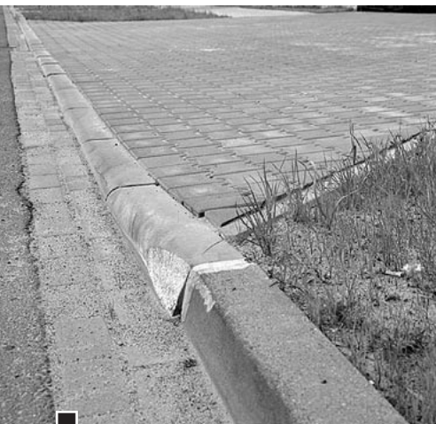
Prowizoryczne dopasowanie starych i nowych krawężników uzupełnione zaprawą betonową fot. Magdalena Nyćkowiak-Filusz
