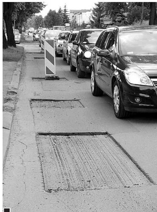
Przygotowane do wypełnienia świeżym asfaltem fragmenty jezdni ul. Żabikowskiej w okolicy skrzyżowania z Pułaskiego i Kościuszki (30.05.2014 r.) fot. Hanna Siatka
