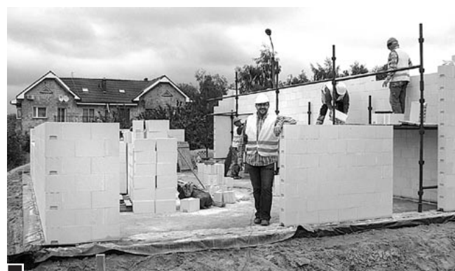
Budowa pierwszego z sześciu domów pasywnych pionierskiego osiedla na ul. Kotowo. Właściciel firmy NEO-BUD – Mariusz Rojewski (stoi na froncie) – jest pasjonatem budowy domów i mieszkań pasywnych i na bieżąco śledzi postępy robót fot. Paweł Wolniewicz
