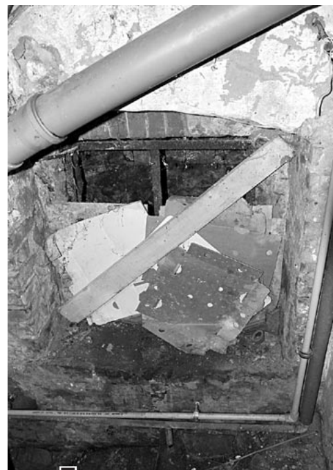
„Kwiatków” do oglądania na tej posesji jest wiele. Tak zabezpieczone jest np. okno piwniczne, oczywiście bez szyby! Decha mająca przytrzymywać kartony. Obok przebiega instalacja kanalizacyjna i wodna, którą po części we własnym zakresie finansowali lokatorzy domu komunalnego fot. Piotr P. Ruskowski
