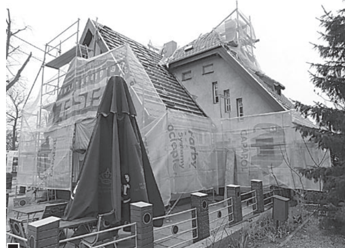
Lubońska firma Bresiński s.c. podczas kładzenia nowych dachówek na zabytkowym budynku „Miodziojadła”, w którym pierwotnie również mieściła się restauracja fot. Hanna Siatka
