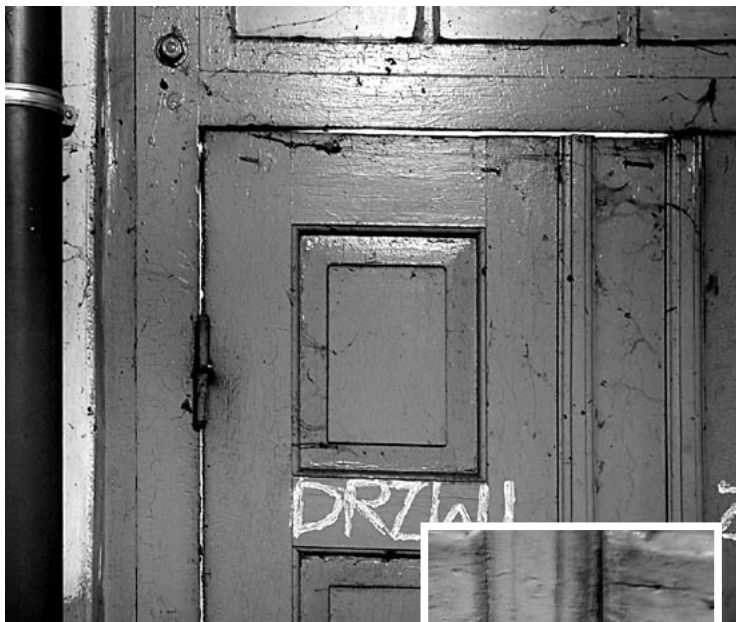
Drzwi wejściowe do domu przy ul. Armii Poznań 111. Widoczne szpary, którymi przechodzi światło i hula wiatr. Podczas zamieci śnieżnej (której w tym roku nie było), można z klatki schodowej zbierać śnieg fot. Piotr P. Ruskowski
