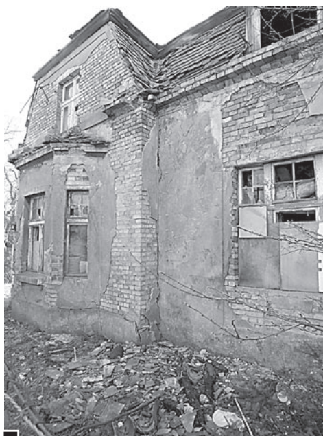
Sypiący się dom przy ul. Poniatowskiego 8. Spada tynk, dachówki, cegły, przepalone belki. Wystające ponad dach uszkodzone kominy ze zlasowaną zaprawą i cegłami, spadając z wysokości, trafić mogą rykoszetem np. na chodnik fot. Hanna Siatka
