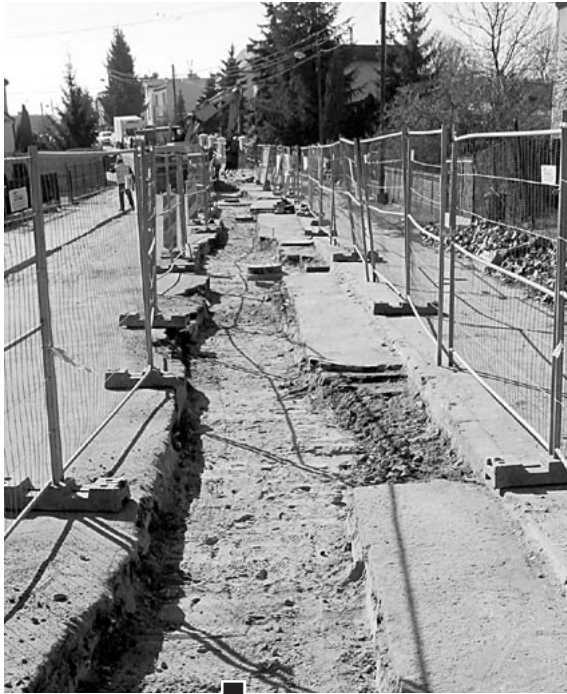
Od strony chodnika asfalt przycięto równo, natomiast od osi jezdni, zamiast przyciąć, wyszarpano fot. Piotr P. Ruszkowski
