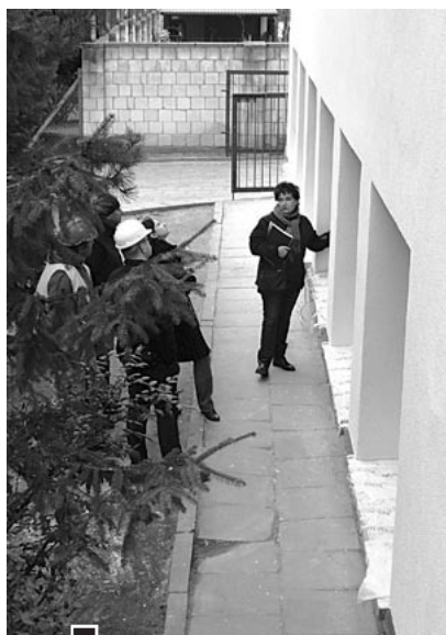
Na placu budowy burmistrz Michał Tomaszuk i inspektor nadzoru budowlanego – Małgorzata Rybarczyk – uzgadniają niektóre detale z wykonawcą fot. Paweł Wolniewicz
