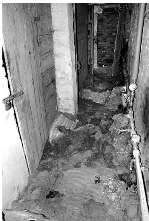
Piwnica domu komunalnego, na posadzce pognite od wilgoci, stare materace, z prawej – podliczniki wody i nowe instalacje (dla dwóch mieszkań), które lokatorzy założyli niedawno we własnym zakresie fot. Piotr P. Ruskowski
