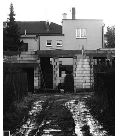
Na pierwszym planie wąski dojazd do nowych domów, dalej powstająca pierwsza kondygnacja szeregowca, w głębi zabudowa ul. Westerplatte fot. Hanna Siatka
