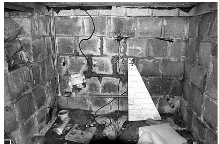
Pod budynkiem gospodarczym w ogrodzie pozostałości po byłym hydroforze i instalacji podłączonej do wodociągu, z której ujawniono wyciek. Naczynia (wiadra, miski, słoiki itd.) stojące na podłodze zalane czystą wodą oraz zamknięte ściany wskazują, że wody w pewnych okresach było dużo fot. Piotr P. Ruskowski
