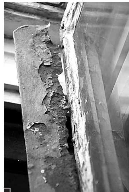
Tak wygląda okap okna w mieszkaniu Grzegorza Ch. na piętrze. Według protokołu przekazania z 25 marca 2013 r. (sprzed roku) „stolarka okienna wraz z parapetami PCV – stan dobry” – w rzeczywistości bardzo stare, drewniane, nieuszczelnione, częściowo spróchniałe, z ubytkami kitu, ze zniszczonymi drewnianymi parapetami! fot. Piotr P. Ruskowski
