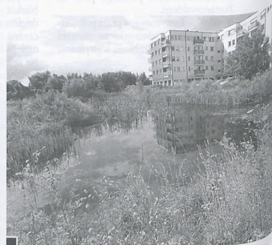
Wykop pod fundamenty bloku, który Przedsiębiorstwo Wiełobranżowe NCS Sp. z o.o. z Poznania od kilku lat planuje postawić przy ul. Wschodniej (naprzeciw poczty), wciąż poszukując partnera do realizacji inwestycji. Zbiornik wypełniony wodą gruntową zarósł i przypomina staw. W wodzie odbicie bloku z ul. Kochanowskiego fot. Hanna Siatka
