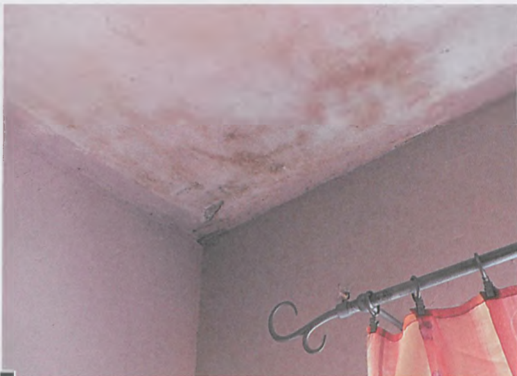
W remontowanych przez lokatorów mieszkaniach budynku od podwórza grzyb pojawia się wciąż na nowo. Na zdjęciu stan ścian latem, kiedy pomieszczenia są wietrzone. Mieszkańcy twierdzą, że zimą tynki są dosłownie zielone od pleśni. Wąski wygospodarowany na potrzeby dwóch mieszkań na piętrze korytarz też jest zawilgocony. Na parterze źródłem przemoczonych ścian może być zła izolacja pozioma lub zapchana i przeciekająca rynna fot. Hanna Siatka
