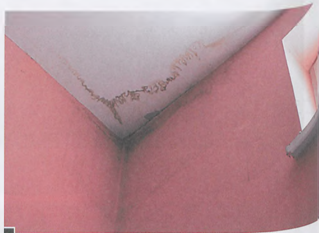
Zacieki na suficie i ścianach klatki schodowej budynku komunalnego położonego od strony ul. Sobieskiego (niedawnej szkoły), poddanego gruntownemu remontowi w 2005 r. fot. Hanna Siatka
