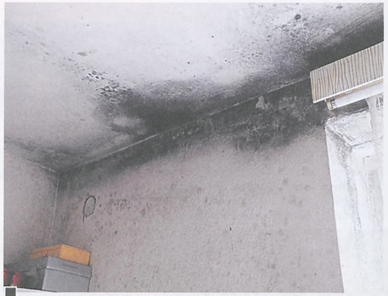
Fragment ściany szczytowej na piętrze starszego segmentu. Lokator mieszkania uważa, że powodem zagrzybienia jest niepoprawnie i w złych warunkach pogodowych wykonany remont dachu oraz opierzeń fot. Hanna Siatka
