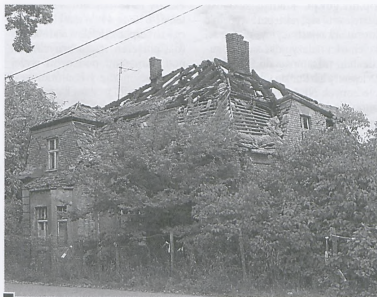
Spalony dach zabytkowej willi fot. Hanna Siatka
