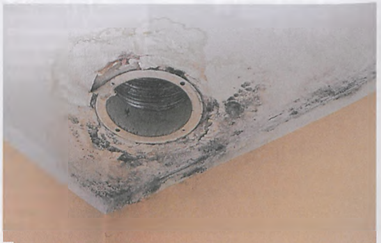
Wadliwie wykonany otwór wentylacyjny, umieszczony w stropie (dach) i zacieki na suficie remontowanej w ubiegłym roku kuchni – w nowszym budynku fot. Hanna Siatka
