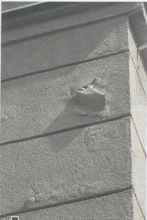
Złuszczający się tynk na frontowej, wykonanej zaledwie 8 lat temu elewacji dawnej SP 4. Z odnowionej niemal w tym samym czasie elewacji starszego budynku (termomodernizację przeprowadzono po generalnym remoncie segmentu położonego od strony ulicy) też „schodzi” tynk. O podobnym zjawisku na innym miejskim budynku – Przedszkolu nr 1 przy ul. Sobieskiego 65 – pisaliśmy w sierpniu br. (str. 46 – „Publiczna robota”) fot. Hanna Siatka
