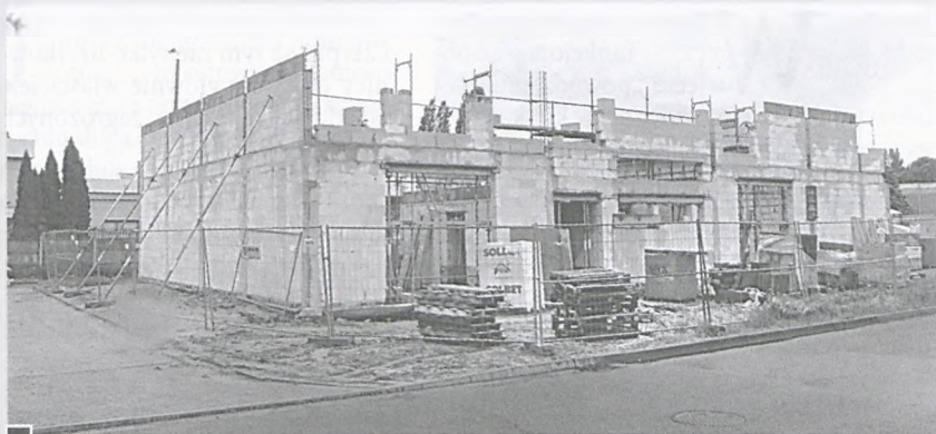
Rośnie budynek poznańskiej firmy „Hondrog” przy ul. Niepodległości. Nadal nie znamy przeznaczenia gmachu. Według pierwotnych zapowiedzi (dokładnie sprzed roku) ma tam powstać hurtownia opakowań fot. Hanna Siatka
