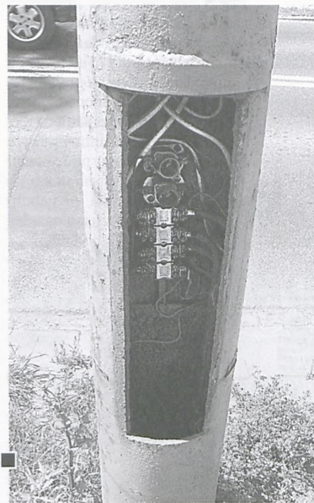
Niezabezpieczone przewody elektryczne stanowią zagrożenie dla przechodniów. fot. Paweł Wolniewicz
