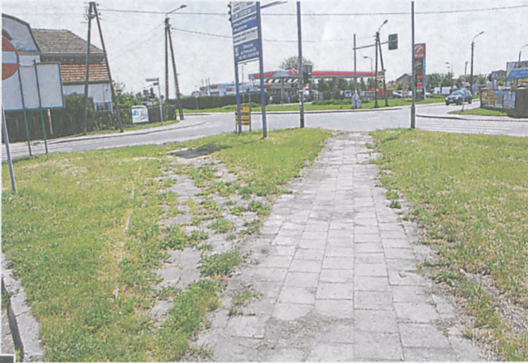
Pozarastane chodniki prowadzące przez zielony plac do przejść dla pieszych na ul. Sobieskiego i Targowej wymagają większej troski. Po przekątnej skrzyżowania (w głębi) widać stację benzynową Orlen fot. Piotr P. Ruszkowski
