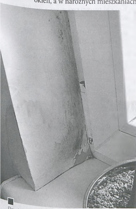
■ Przykład zawiągniętego otworu okiennego w budynku komunalnym (ul. Źródłana 3 a) – stan po zimie fot. Hanna Siatka
