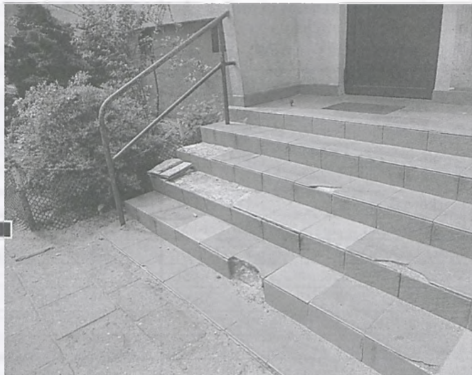
Przykład zniszczonych po zimie stopni przy klatce schodowej na ul. Żabikowskiej 52 fot. Władysław Szczepaniak
