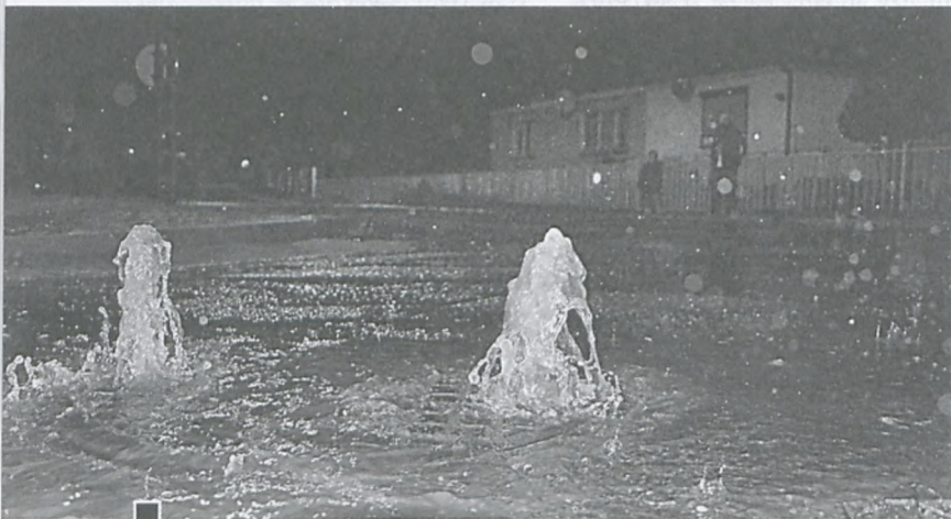
Sikające ścieki przez wszystkie możliwe dziury w klapach studzienek kanalizacyjnych na ul. 3 Maja (przy Lemańskiego) i Krańcowej. 30 maja 2013 r. ok. godz. 21.30 fot. Piotr P. Ruszkowski
