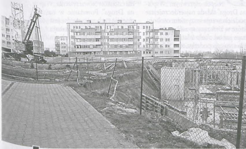
Miejsce osunięcia gruntu – widok od strony parkingu przy bloku z adresem: al. Jana Pawła II 15 b. Tuż za nim siatka parkanowa, przy której niebezpiecznie osunęła się ziemia fot. lubon.tv
