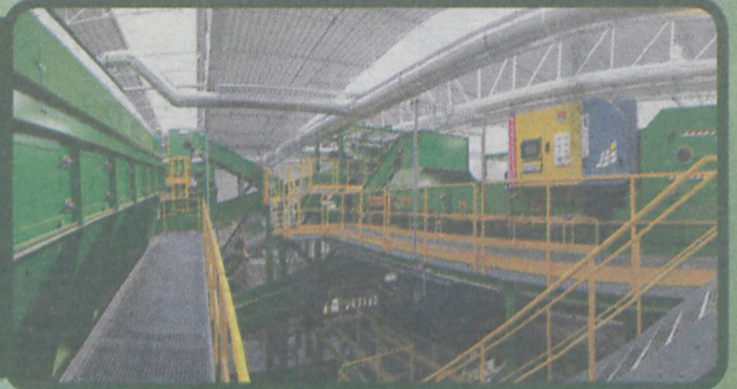
Linia do mechanicznego sortowania odpadów komunalnych
