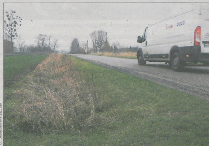
Chwasty w rowach sięgają już ponad poziom asfaltu
