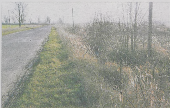
Nie tylko droga z Noskowa do Góry wymaga remontu, ale także rowy wzdłuż niej musiałyby zostać uporządkowane
