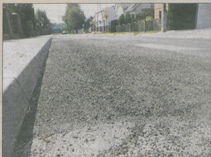
Efekt remontu przeprowadzonego przez Drobud na ul. Słonecznej pozostawia wiele do życzenia
