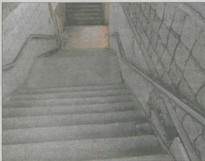
Z peronu do odrestaurowanego dworca kolejowego w Jarocinie widać zrujnowane przejście podziemne. W tym roku nie doczeka się remontu
