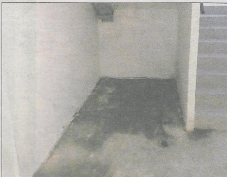
Choć budynek oddano do użytku zaledwie pół roku temu, wiele pomieszczeń uległo już zagrzybieniu
