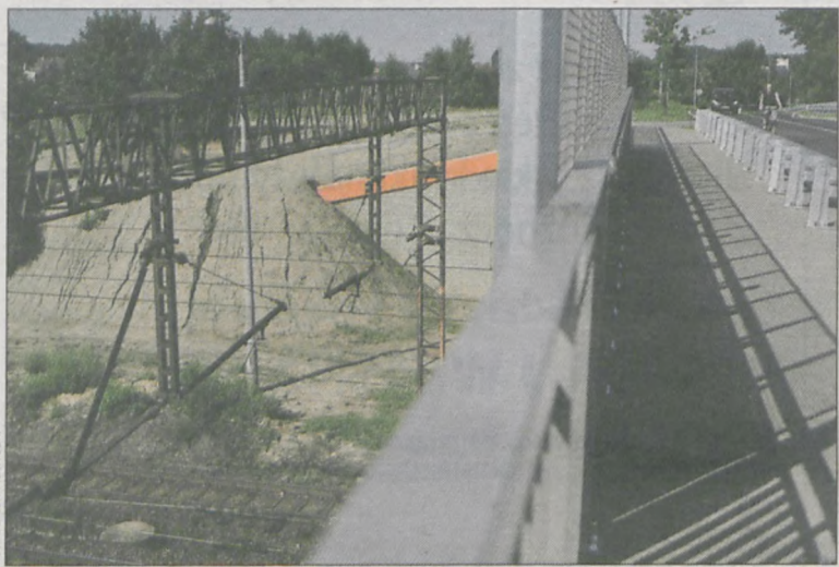
Skanska udzieliła powiatowi pięcioletniej gwarancji na przebudowane wiadukty. Może się ona przydać, bo skarpy - mimo poprawek - nie wyglądają najlepiej
