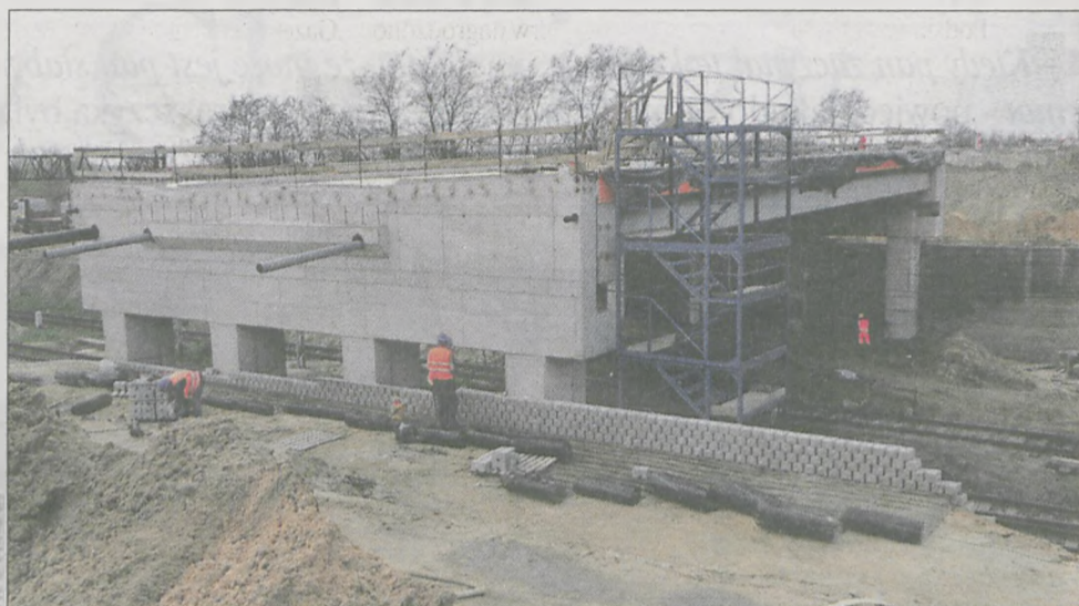
Wiadukty na ul. Powstańców Wlkp. w Jarocinie będą przejezdne w lipcu, może w sierpniu - takie terminy padły na posiedzeniu rady powiatu
