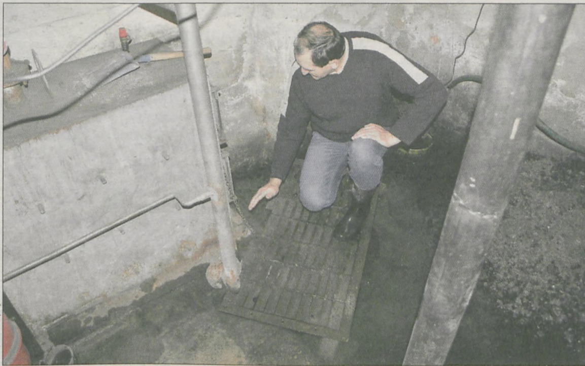
Tadeusz Kościelniak pokazuje skorodowany piec
