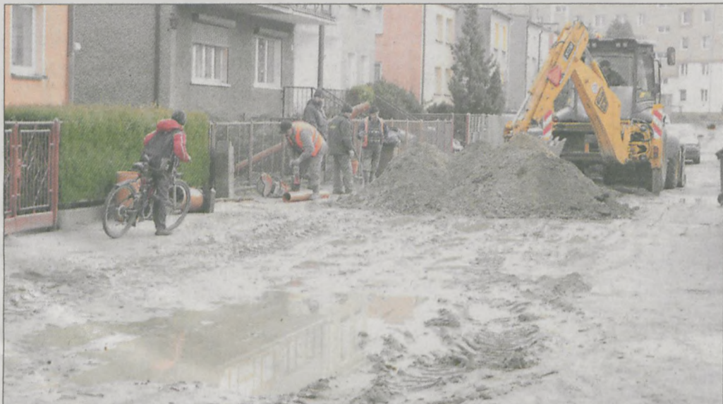
Wymiana sieci wodociągowej oraz budowa kanalizacji deszczowej i sanitarnej na osiedlu 1000-lecia trwa od września
