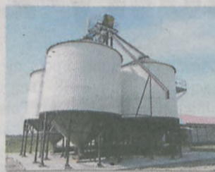
Linie technologiczne magazynów zbożowych
