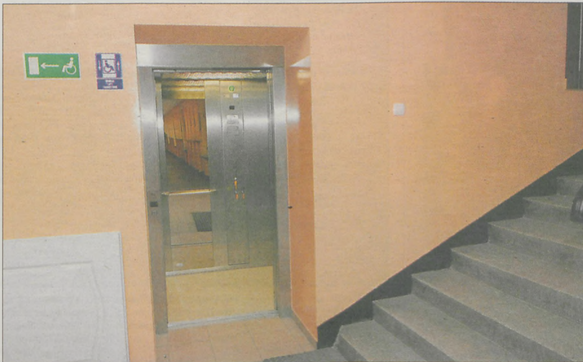
Windę z trzema wyjściami dociera się na każdy poziom w szkole. Jej montaż kosztował 250 tys. zł. Pieniądzy wystarczyło też na remont świetlicy, jadalni i odświeżenie pomieszczeń klas I-III. Szkoła na te prace wydała 135 tys. zł
