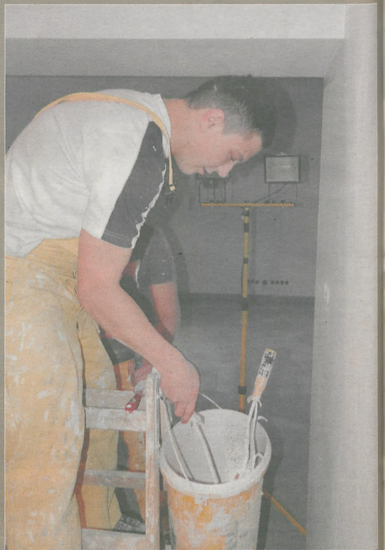
Praktykant na zdjęciu to uczeń drugiej klasy szkoły zawodowej. Sprzątanie i mycie narzędzi oraz parzenie kawy ma już za sobą. Teraz robią to młodzi koledzy, a on uczy się konkretnych prac budowlanych
