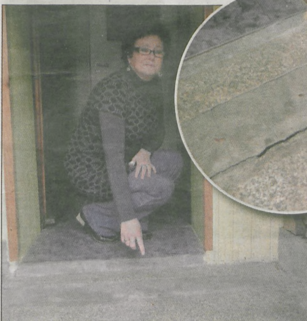
Dorota Bajka z Lgowa pokazuje szczelinę, która powstała między ścianą domu, w którym mieszka, a schodami wejściowymi
