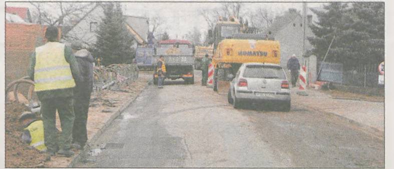
Ruch pojazdów na ul. Golskiej w Jaraczewie jest utrudniony przez prace związane z kanalizacją
