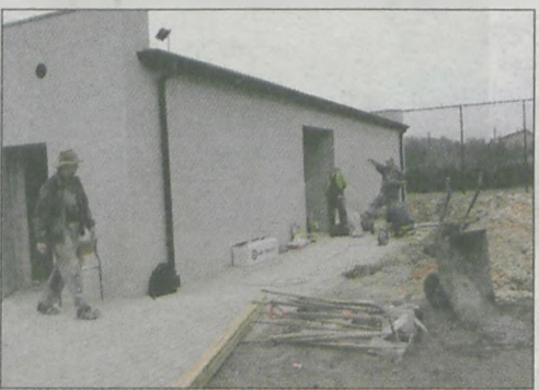
W miniony czwartek trwały prace przy doprowadzeniu wody i ogrzewania do budynku socjalnego
