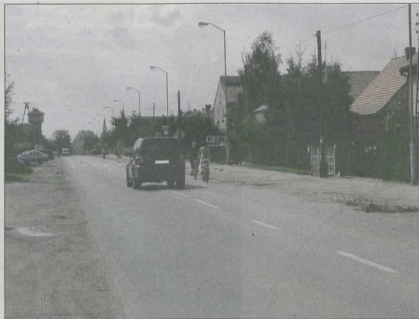
DO MOMENTU POŁOŻENIA NAWIERZCHNI asfaltowej na ul. Żerkowskiej, roboty na Św. Ducha będą prowadzone na pół gwizdka, żeby nie sparalizować ruchu w tej części Jarocina
