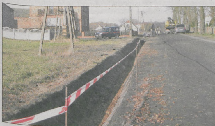
NIECO DALEJ od miejsca kolizji, rów jest oznaczony taśmą ostrzegawczą
