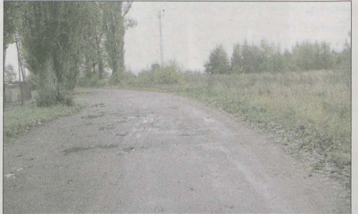
NAJPRAWDOPODOBNIEJ dopiero w przyszłym roku będzie nowa nawierzchnia na ul. Spółdzielczej w Górze
