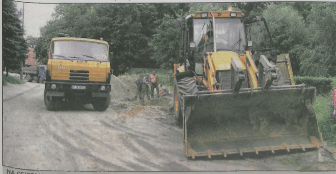
NA OSIEDLU 1000-LECIA wykonana ma zostać kanalizacja sanitarna i deszczowa oraz remont pięciu ulic
