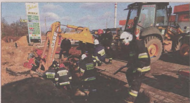
DO ODKOPANIA przysypanego mężczyzny wysłano 4 zastępy straży
