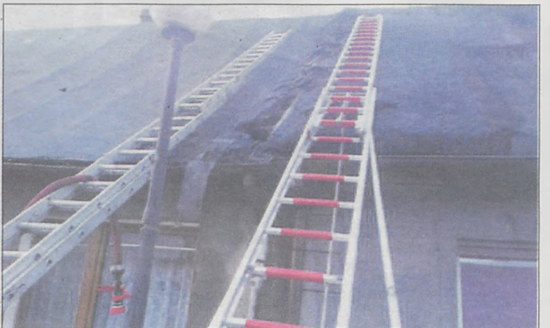
Niebezpieczeństwo zostało zażegnane przez straż pożarną w ciągu dwóch godzin
