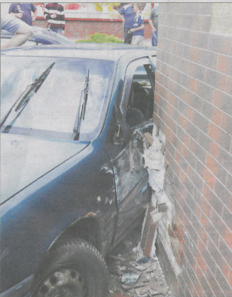
Czy właścicielka domu dostanie odszkodowanie za zniszczenia?
