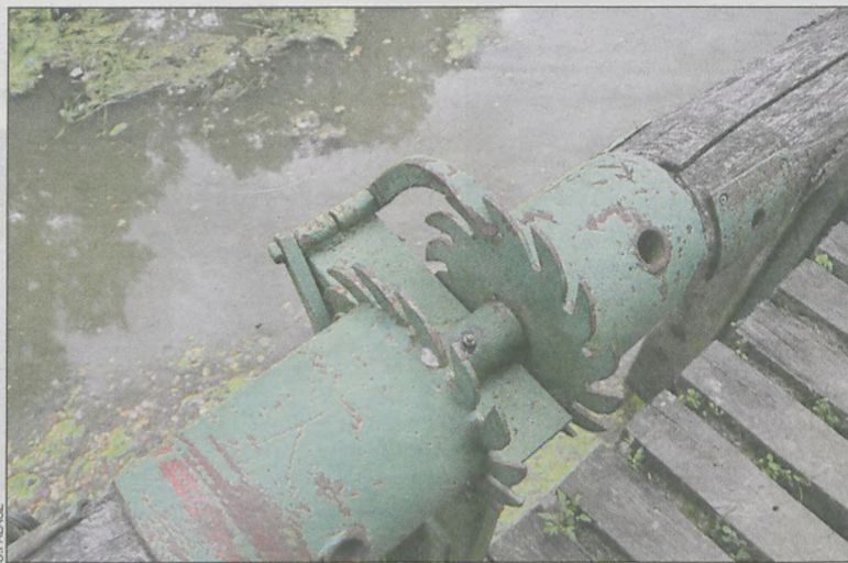
Fragment urządzenia zamontowanego na jazie
