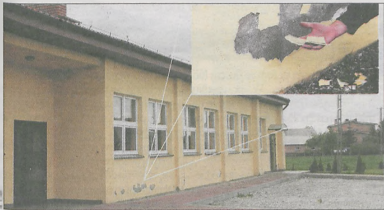
Jedną z potrzeb wsi jest naprawa zniszczonej elewacji świetlicy
