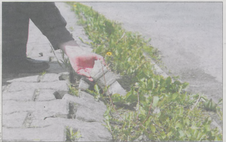
Chodniki są zapadnięte i brakuje w nich kostki
