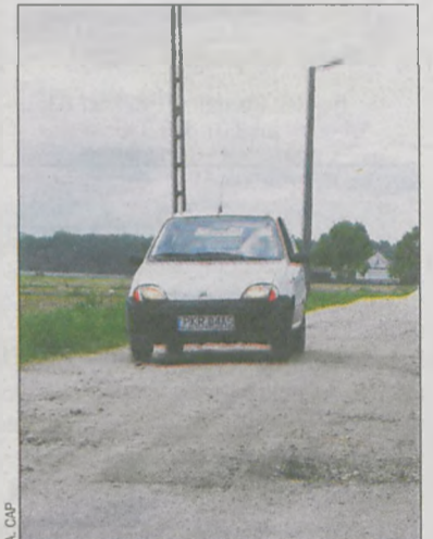
Droga w miejscowości Rudy potrzebuje modernizacji
