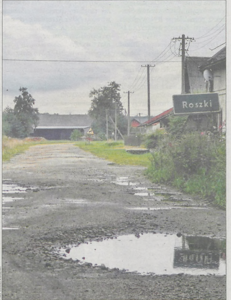
Droga w Roszkach jest jedną z bardziej zniszczonych w powiecie
