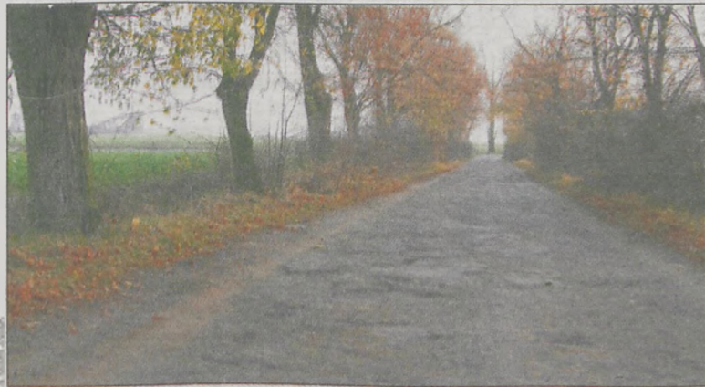
Fatalna droga doskwiera kierowcom od lat
