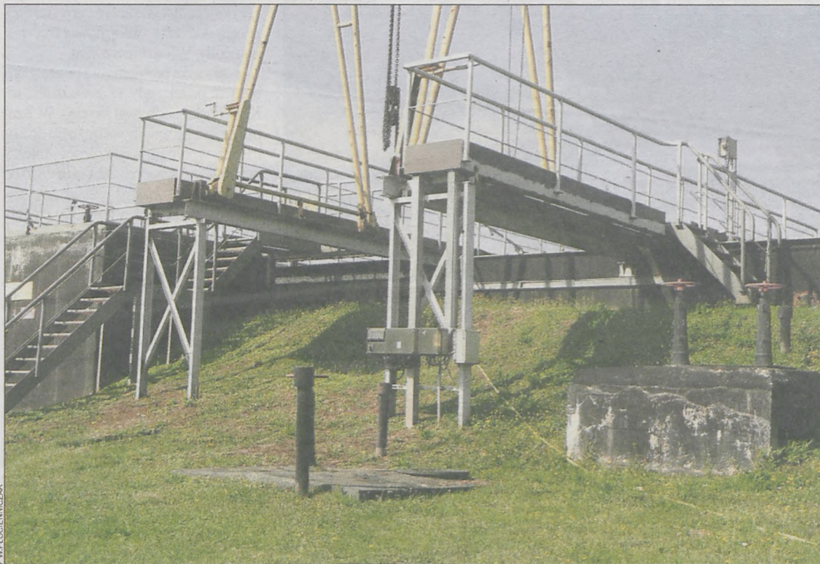
Remont oczyszczalni jest pilnie potrzebny
