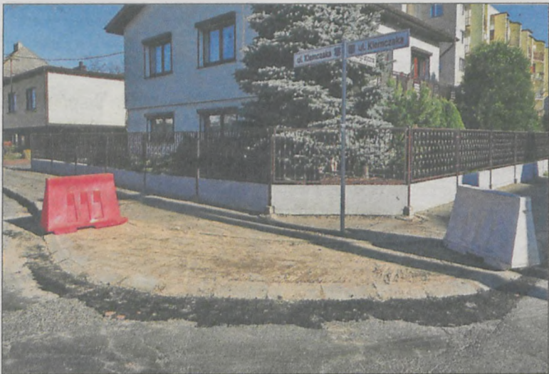
Interwencja władz pomogła. Powiat podjął się naprawy krawężnika
