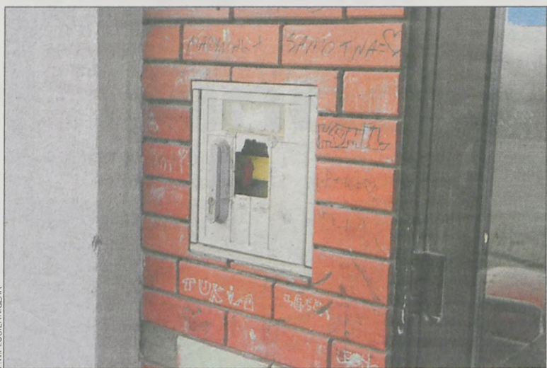
Wiele elementów instalacji po prostu zniknęło
