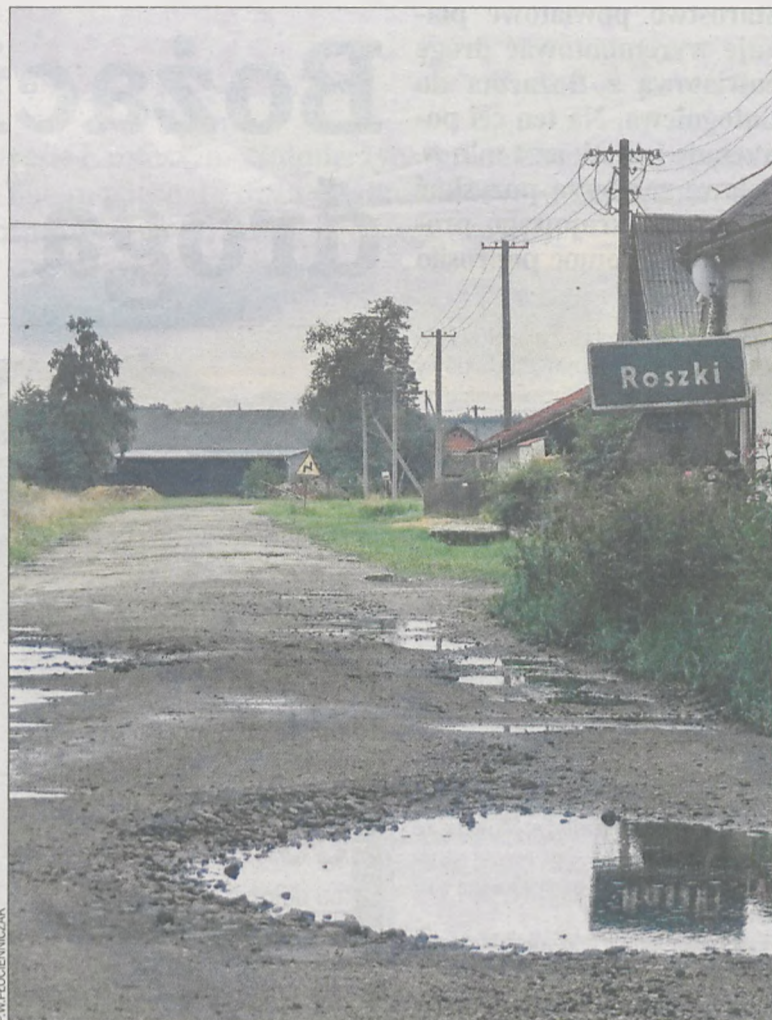
Nawierzchnia ul. Dobrzyckiej w Roszkach jest w katastrofalnym stanie
