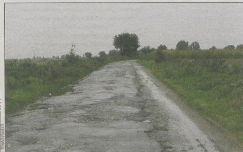
Droga Powiatowa łącząca Skałów z Gościejowem jest w fatalnym stanie
