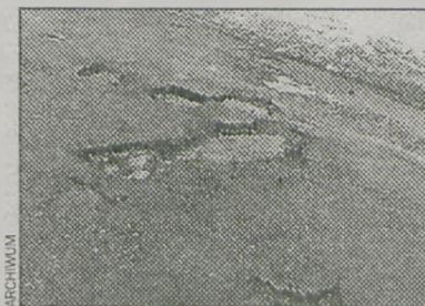
Dziury zostaną polatane. Gruntowna modernizacja musi poczekać
